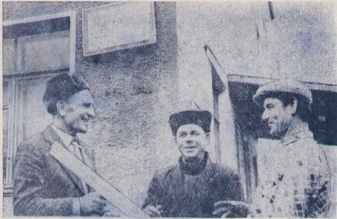
Заканчиваются строительные работы на опорном пункте милиции при Ивановском сельском Совете. Реконструкция и ремонт здания проведены бригадой плотников, которую возглавляет Василий Яковлевич Русанов. НА СНИМКЕ (слева направо): бригадир В. Я. Русанов, каменщик И. П. Мельников, плотник Н. И. Парфенов. Фото П. Брягуна.
